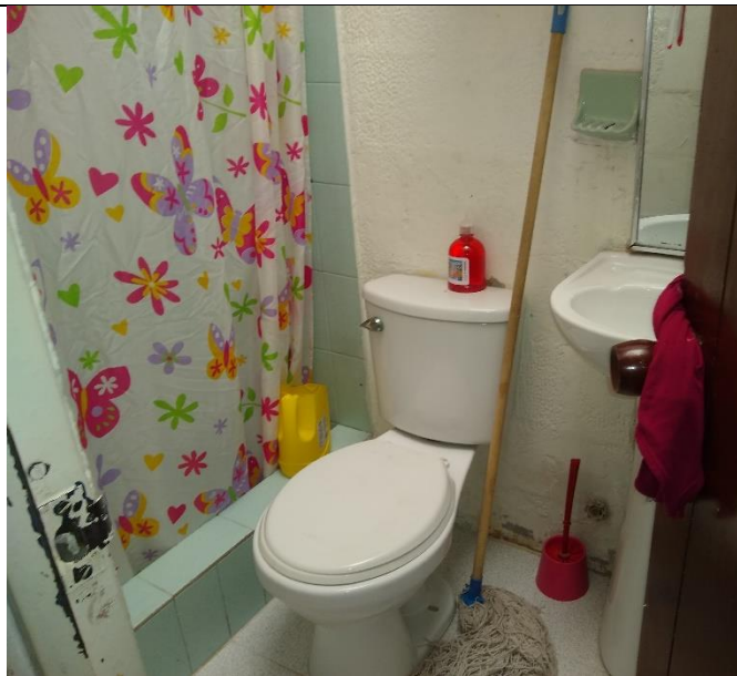
Foto No. 8 Detalle de acabados en baño.
