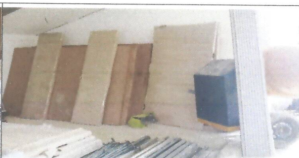
Imagen 2. Almacenamiento de materiales acústicos
