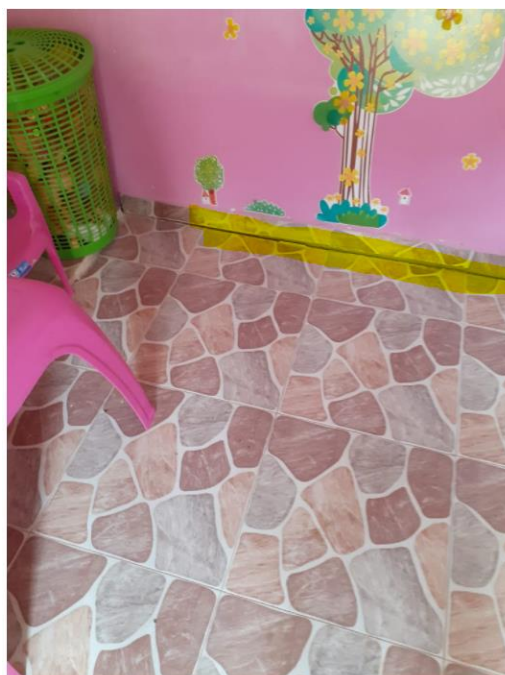
Figura 33 Vivienda propiedad del alcalde LIBARDO OBANDO GOMEZ, presenta dilataciones verticales , separación de muros.
