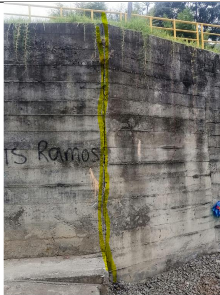
Figura 45 Zona urbana acceso de escaleras del barrio Primavera hacia el barrios el bosque – Coliseo patología por problemas de suelo.
