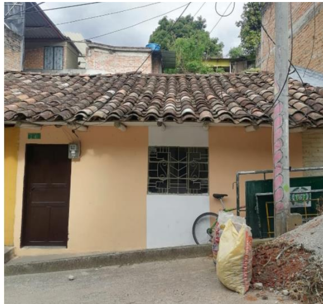
Figura 40 Vivienda propiedad Carmen Ramos presenta patología por problemas de suelo.
