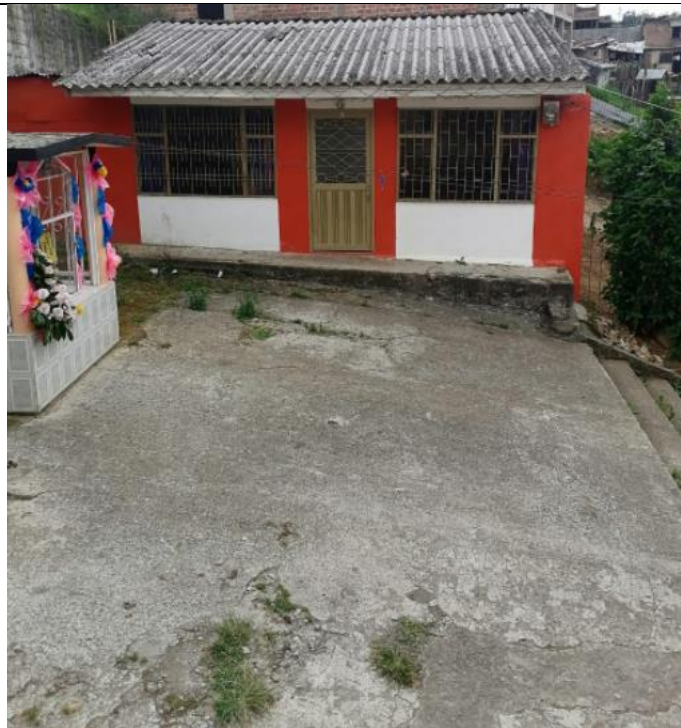
Figura 36 Vivienda propiedad Johana Gustin, presenta patología por problemas de suelo.
