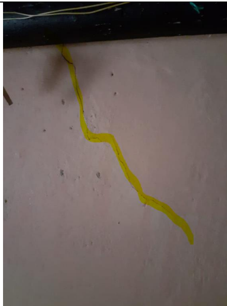
Figura 41 Vivienda propiedad Carmen Ramos presenta patología por problemas de suelo.
