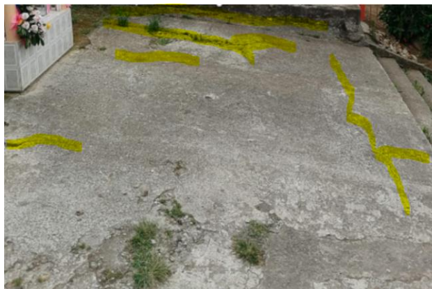
Figura 44 Zona urbana acceso de escaleras del barrio Primavera hacia el barrios el bosque – Coliseo patología por problemas de suelo.
