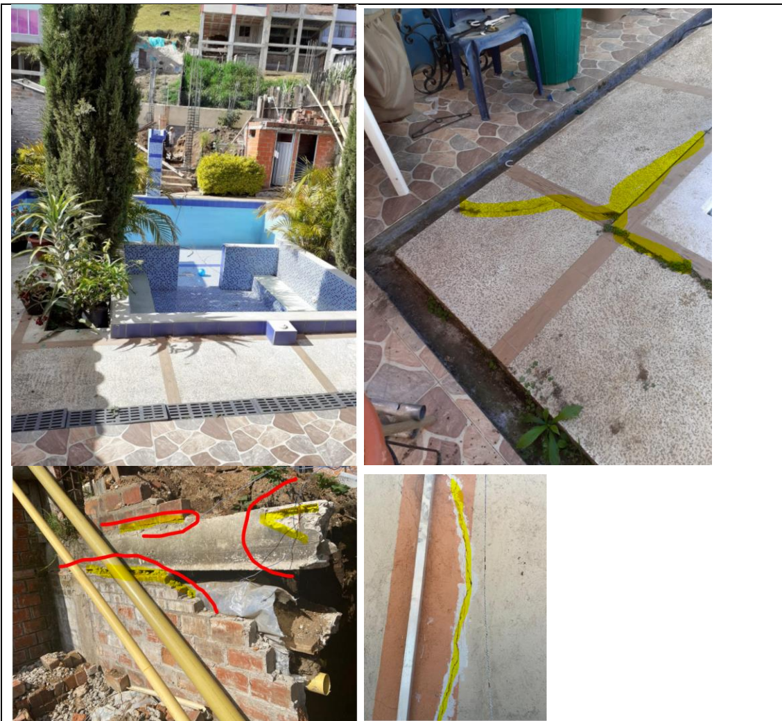
Figura 34 Vivienda propiedad del alcalde LIBARDO OBANDO GOMEZ, presenta patología por problemas de suelo.
