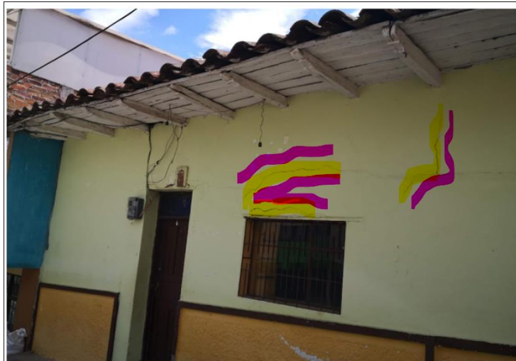
Figura 28 Vivienda fisurada la fachada propiedad del señor Herminsul Salas y Pastora Salas ubicada en el barrio primavera al frente de la casa del señor Heraldo Jiménez.
