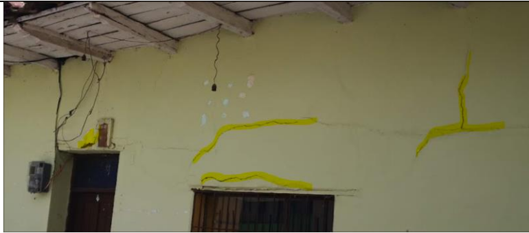
Figura 29 Vivienda fisurada la fachada, propiedad del señor Herminsul Salas y Pastora Salas ubicada en el barrio primavera al frente de la casa del señor Heraldo Jiménez.
