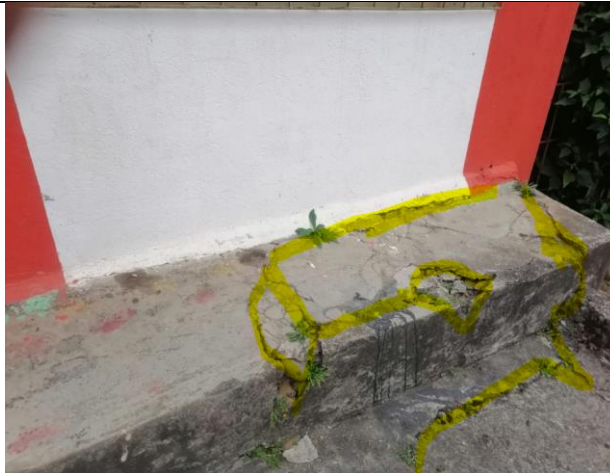
Figura 37 Vivienda propiedad Johana Gustin, presenta patología en el andén por problemas de suelo.
