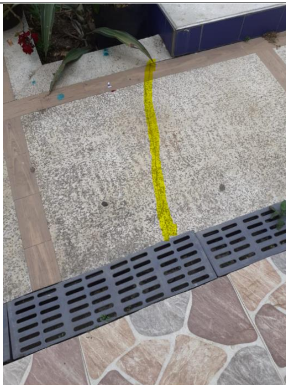
Figura 32 Vivienda propiedad del alcalde LIBARDO OBANDO GOMEZ, presenta fisuras en el pisos.
