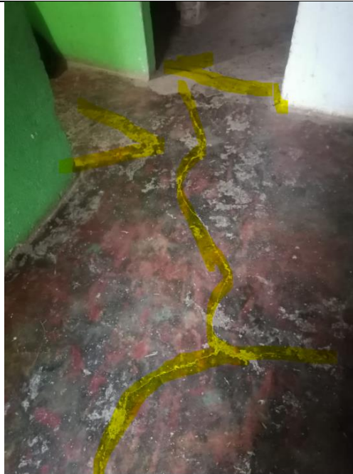
Figura 38 Vivienda propiedad Johana Gustin, presenta patología en el andén por problemas de suelo.
