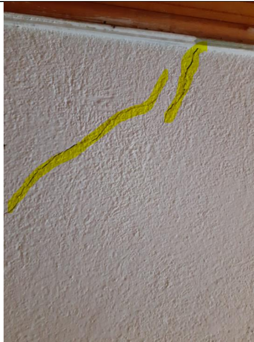
Figura 42 Vivienda propiedad Carmen Ramos presenta patología por problemas de suelo.
