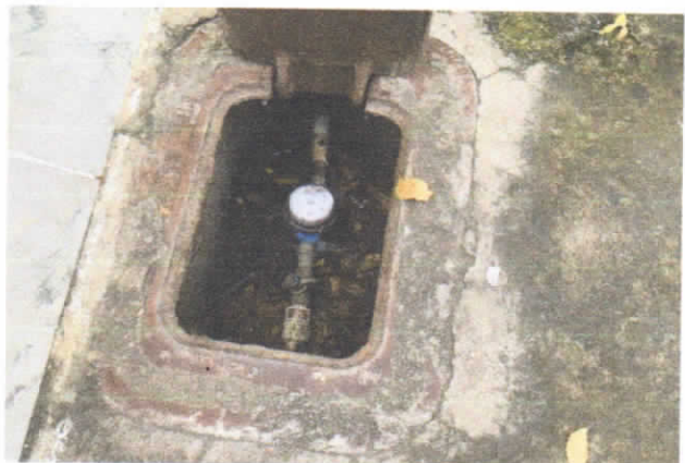
CONTADOR DE AGUA
