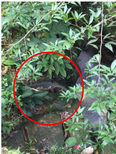
Fotografía No. 5 Vertimiento de las aguas del alcantarillado al cuerpo de agua. Fuente: Diego Cartagena(2020)
