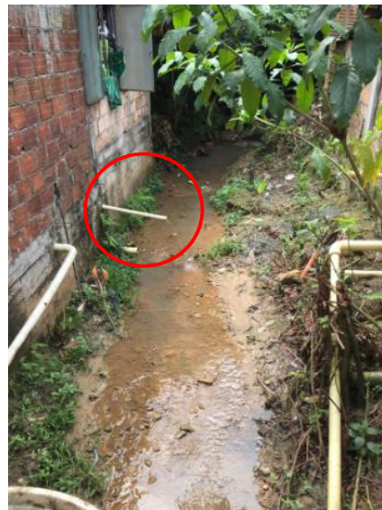
Fotografía No. 2 Vertimiento de aguas domesticas. Fuente: Diego Cartagena (2020)
