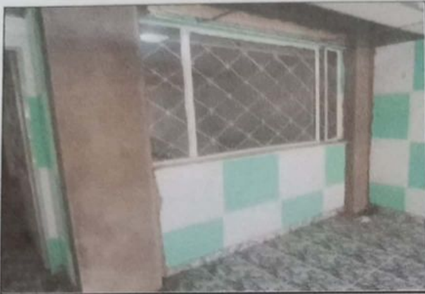
AFECTACIONES AL INMUEBLE
