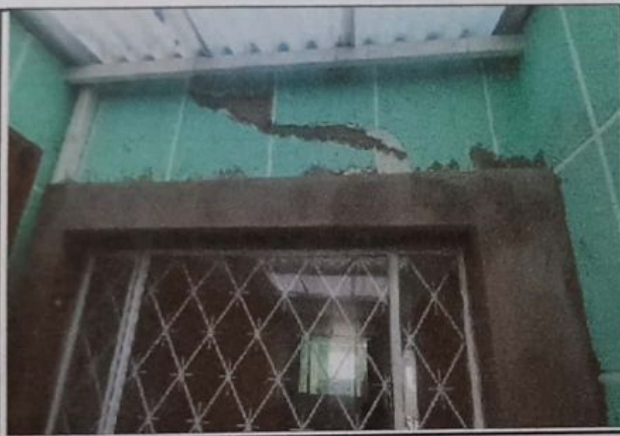
AFECTACIONES AL INMUEBLE
