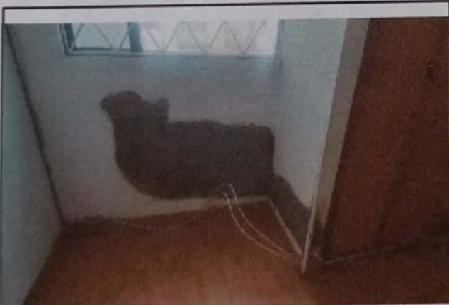
AFECTACIONES AL INMUEBLE
