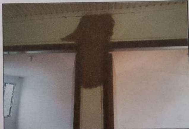
AFECTACIONES AL INMUEBLE
