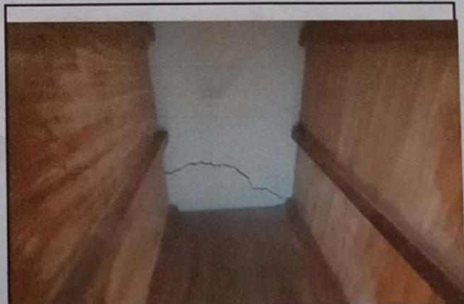
AFECTACIONES AL INMUEBLE
