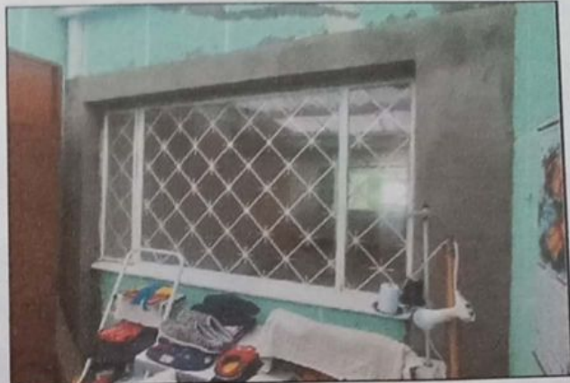
AFECTACIONES AL INMUEBLE
