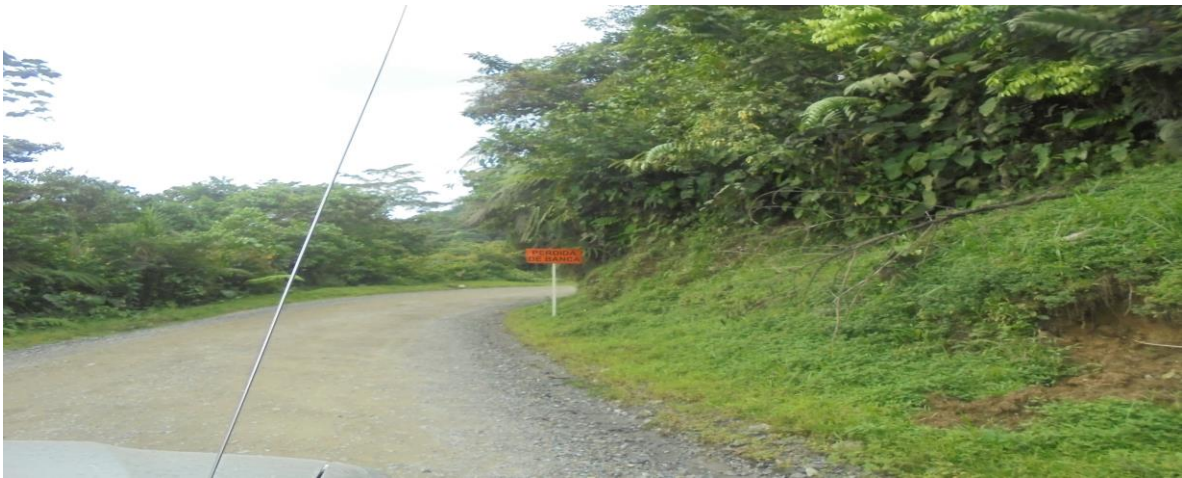
Señal vertical perdida de la banca 66+400
