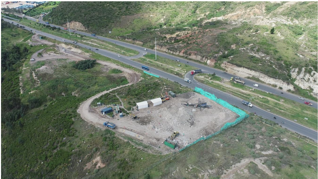
Imagen 6. Afectación del predio denominado “Lote Serafín” a fecha 24 de septiembre de 2020, llevada a cabo por la UAESP, según CGR DJ
