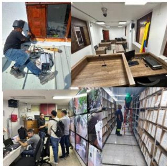
Figura 13. Mantenimiento sistema de incendios
