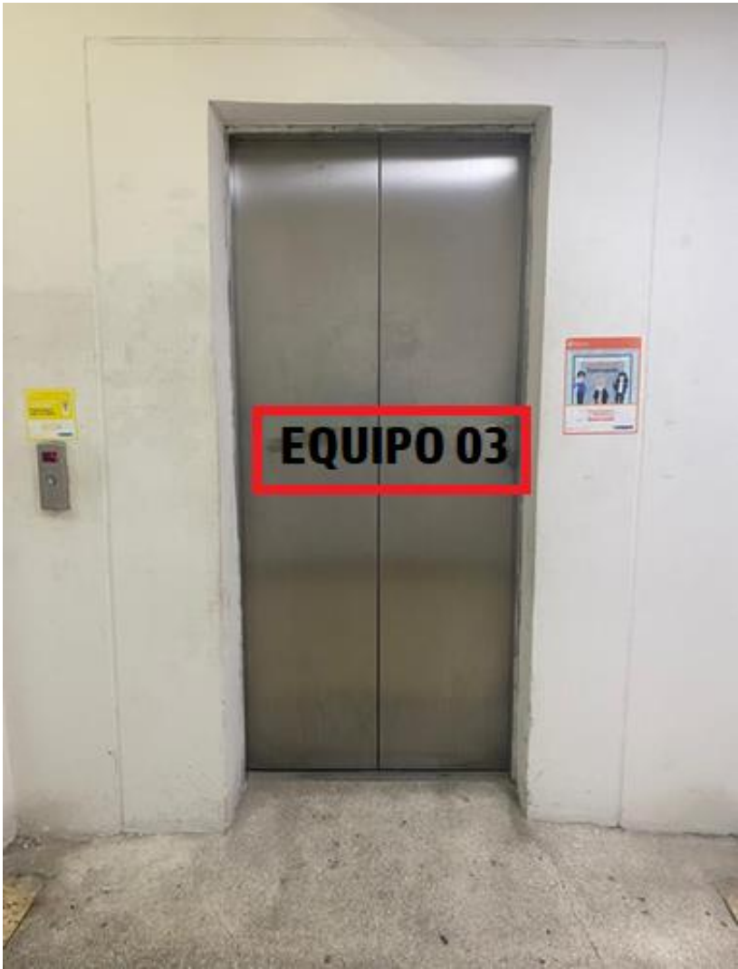
ASCENSORES OTIS EDIFICIO TELECOM
