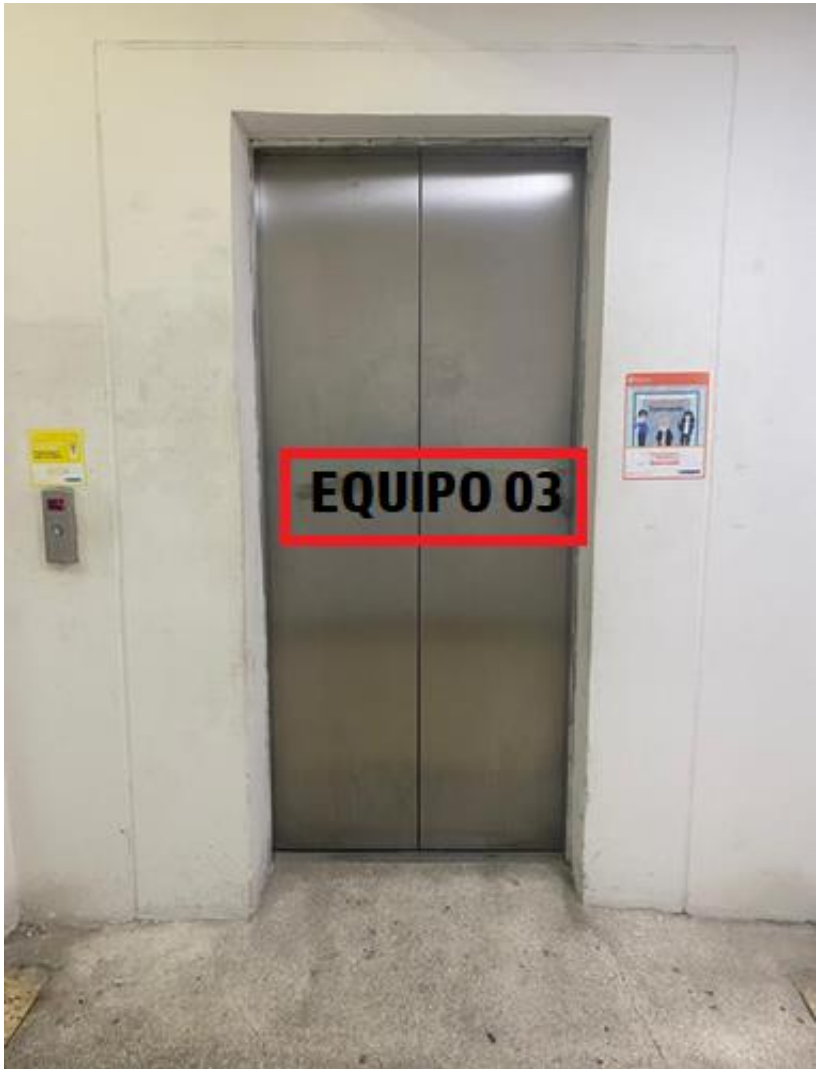
ASCENSORES OTIS EDIFICIO TELECOM
