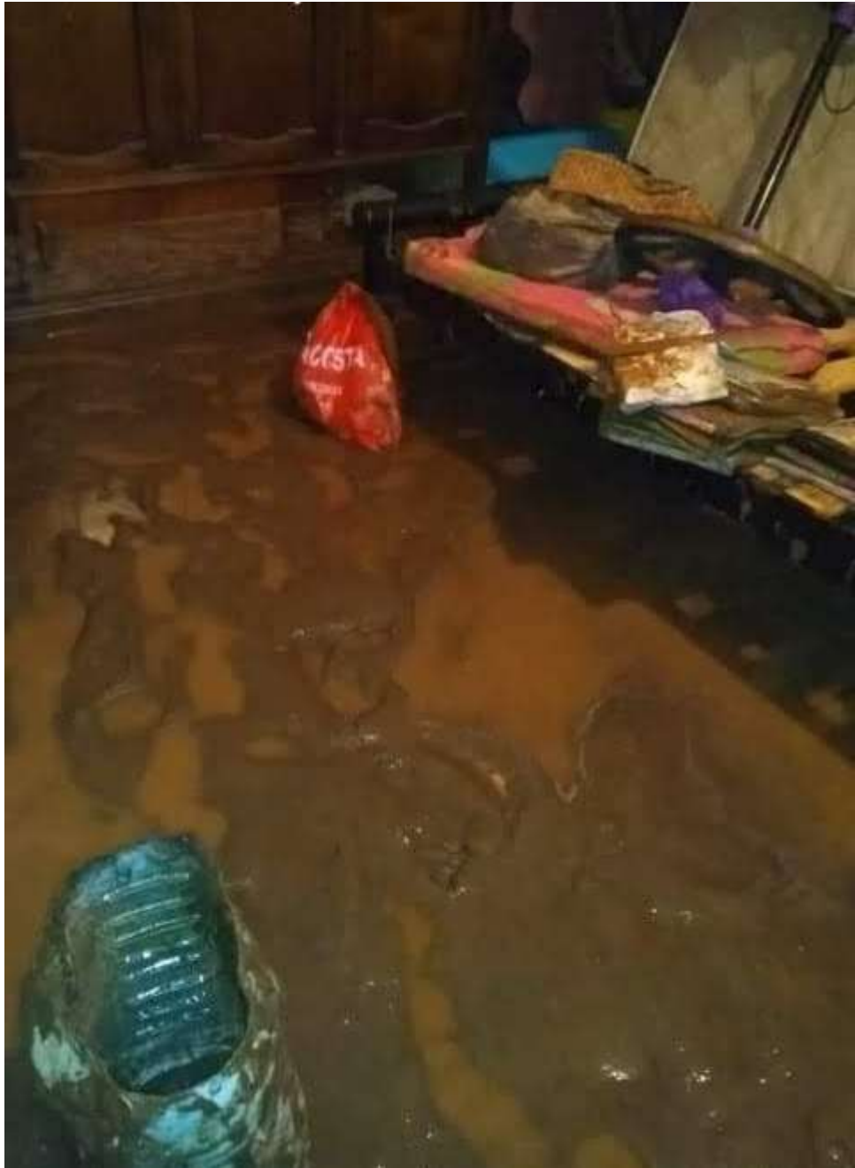
IMAGEN 11: Alcoba de una de las casas afectadas por el desbordamiento de la muralla.
