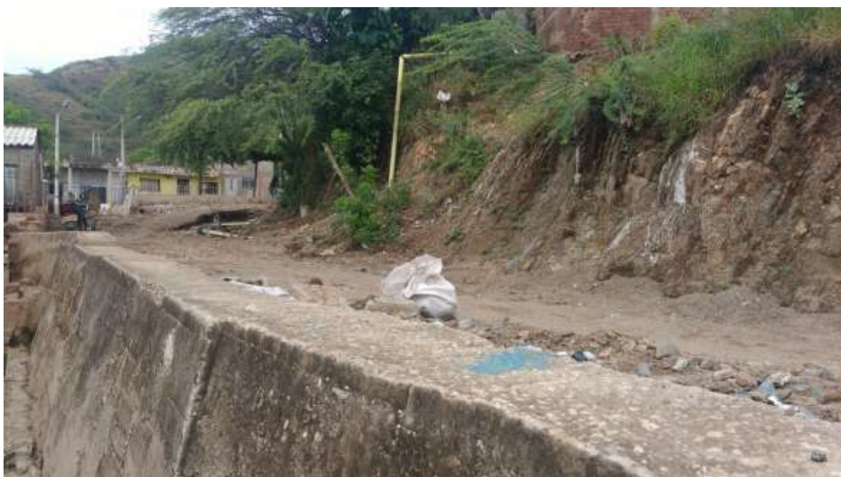
IMAGEN 2: Pendiente de donde proviene el deslizamiento del sedimento.
