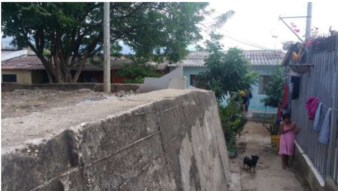
IMAGEN 4: Sedimento al mismo nivel de la muralla, con laminas puestas por la comunidad para evitar la afectación a los hogares.
