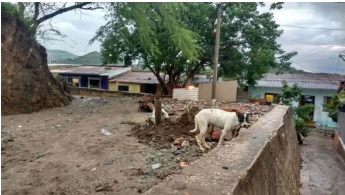
IMAGEN 6: Sedimento al mismo nivel de la muralla.
