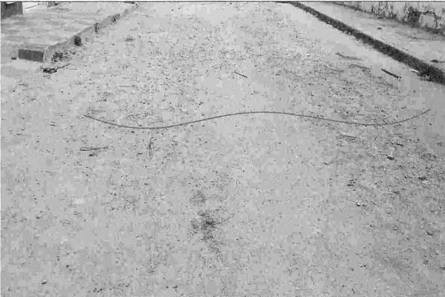
Fotografía 4. Ahuellamiento presente en la estructura de pavimento, presentándose depresión en la zona localizada sobre la trayectoria de las llantas de los vehículos, con presencia de elevación de las áreas adyacentes.
