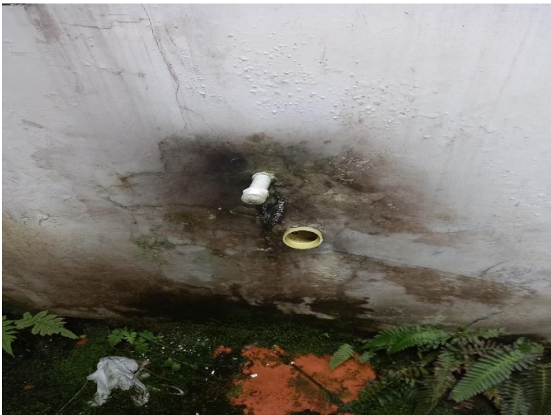
Punto hidráulico y sanitario
