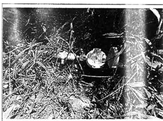
Contador de Agua
