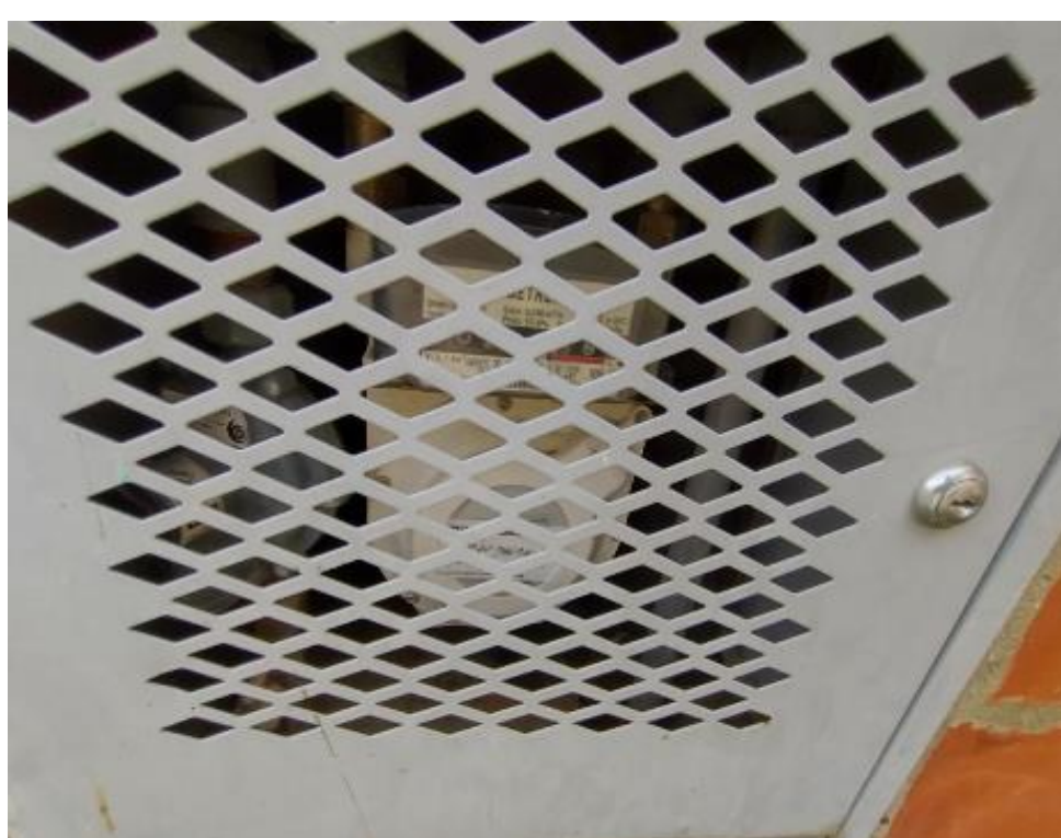
CONTADOR DE GAS
