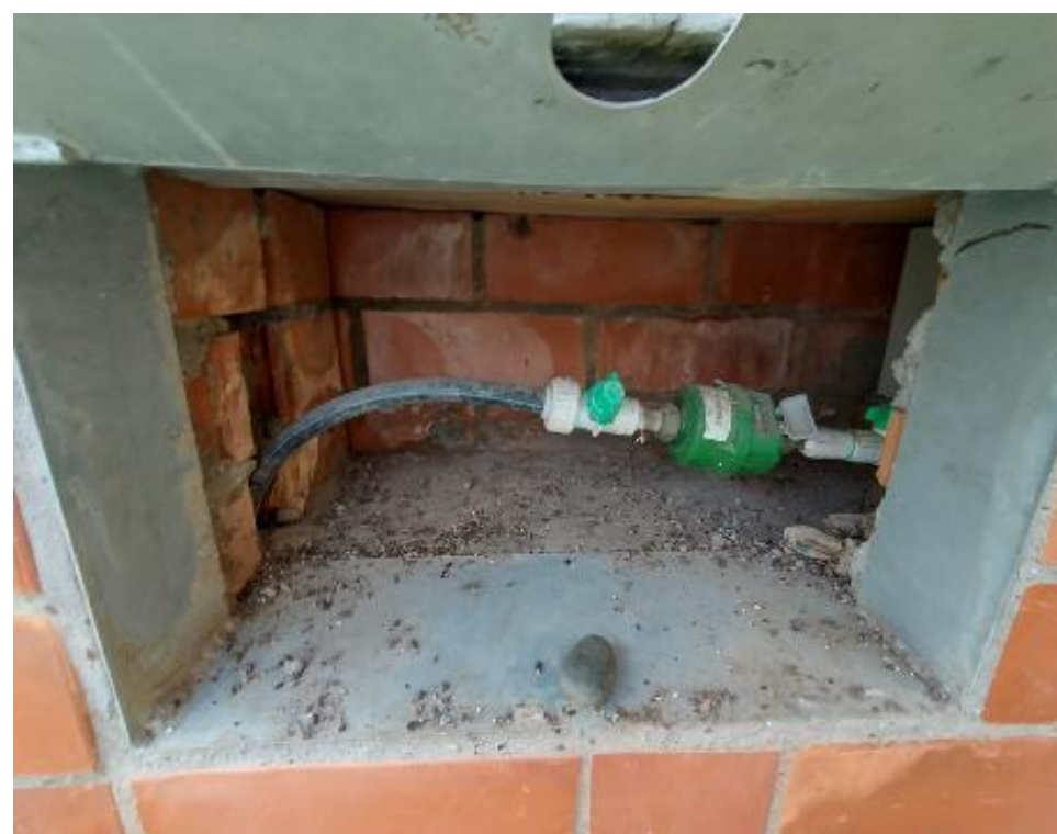
CONTADOR DE AGUA
