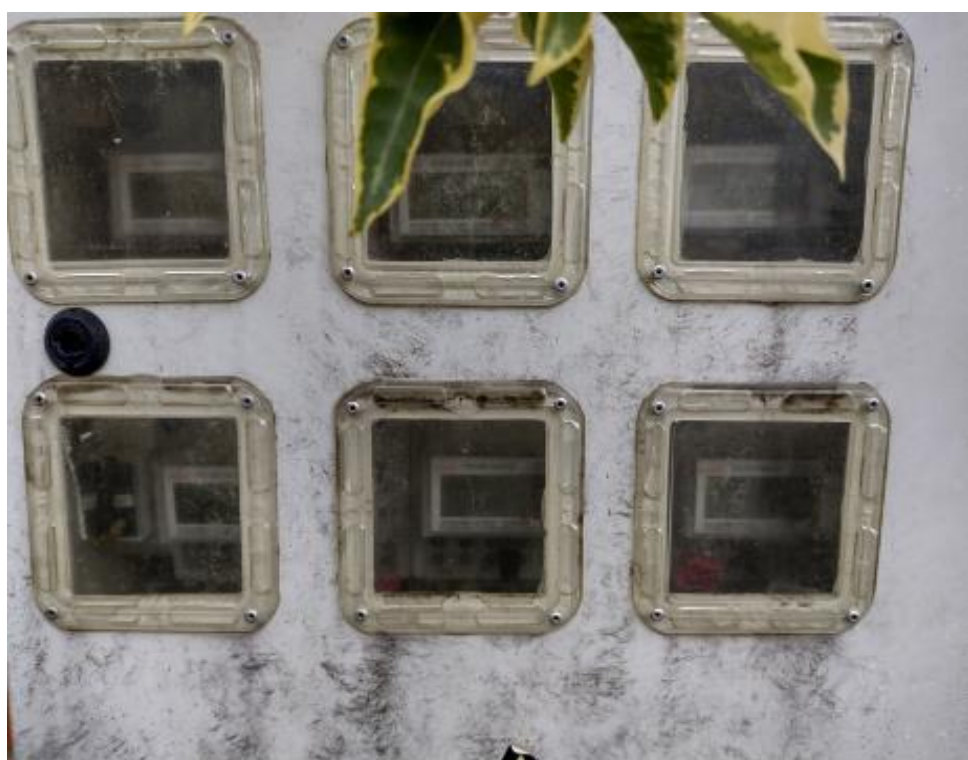
CONTADOR DE ENERGIA
