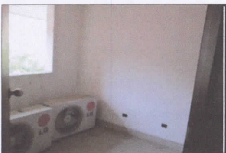
ZONA DE CONDENSADORAS AIRE ACONDICIONADO
