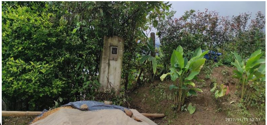
ACOMETIDA DE ENERGIA
