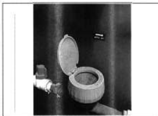
Medidor de agua potable
