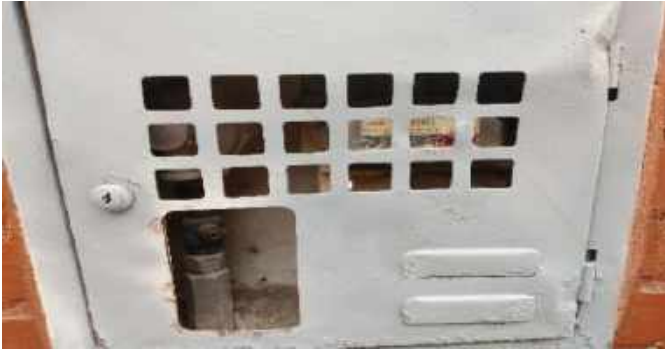
Contador de Gas
