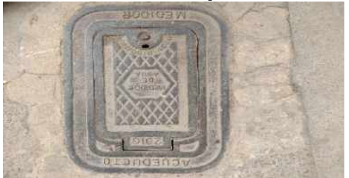
Contador de Agua
