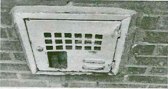
Contador de Gas
