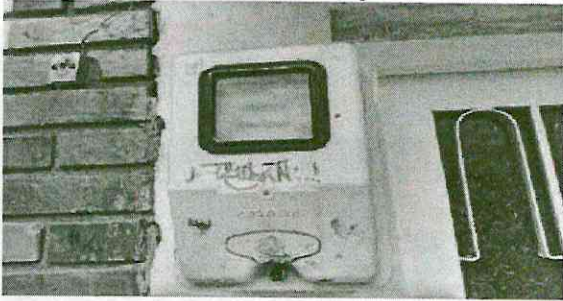
Contador de Energía
