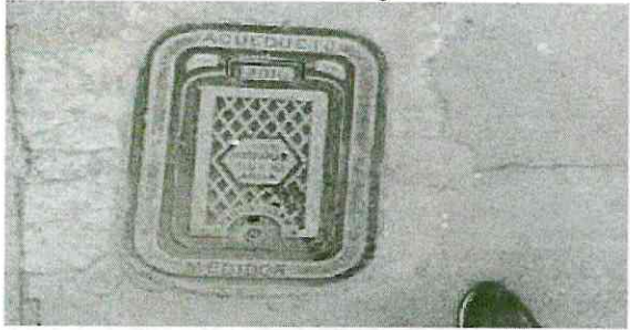
Contador de Agua
