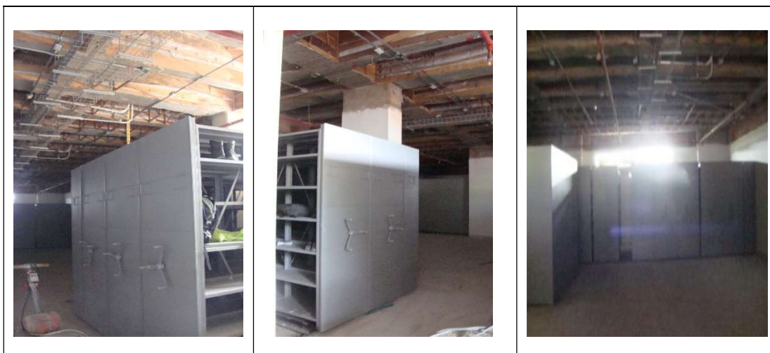
Área de archivo inactivo en el sótano. Este archivo rodante actualmente no permite destroncar el piso instalado bajo el archivo ni quitar la formaleta de caseton sobre el mismo. (Fotos DSC7494 a DSC7496)
