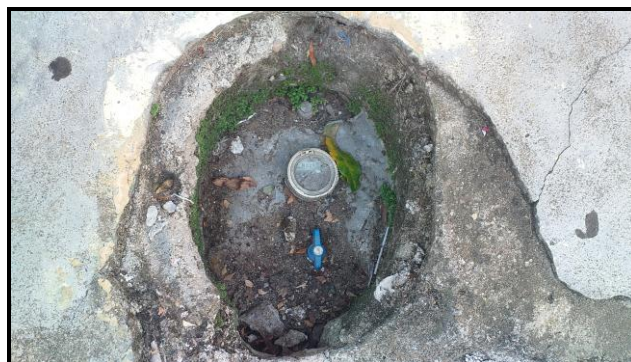
CONTADOR DE AGUA
