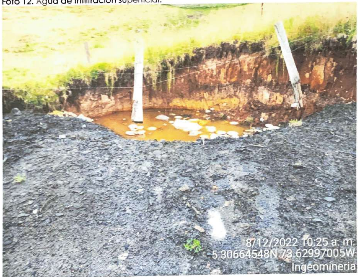
Foto 12. Agua de Infiltración superficial.
