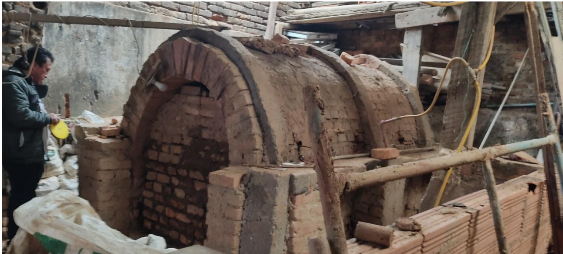
HORNO PARA SECADO DE BRIQUETAS CON INSTALACION A GAS
