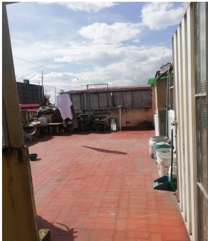
Terraza cuarto piso - se evidencia sin cubierta siendo un espacio abierto
