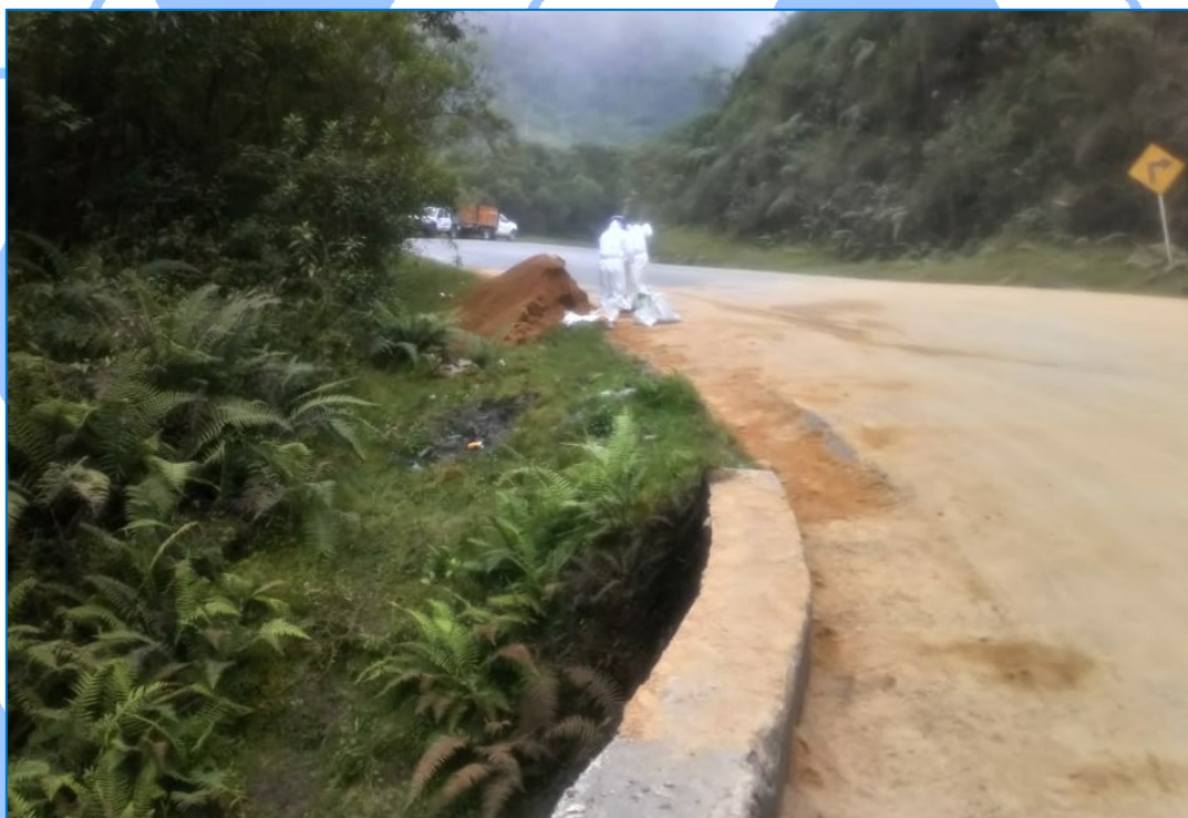
Fotografía 6: Labores complementarias a la Inspección técnica realizada al siniestro.
