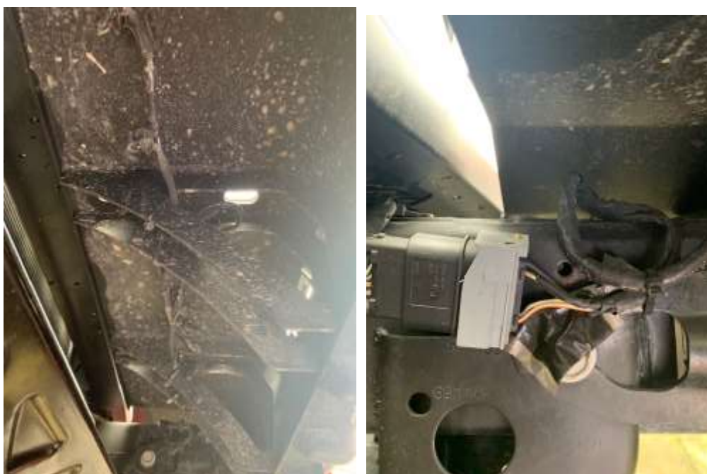
Fotografías 13. Suministrada por Automotriz Italoamerica S.A.S para análisis y evaluación de la instalación eléctrica realizada. Se observa cableado protegido con cinta aislante y sin la funda de protección.
