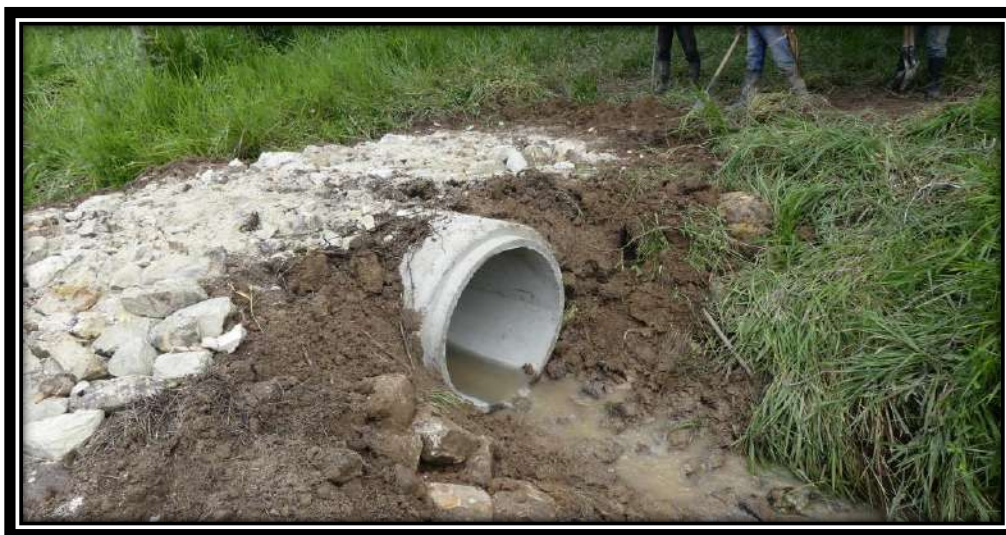
Fotografía 3634 Ubicación Tubería camino real Sector B.
