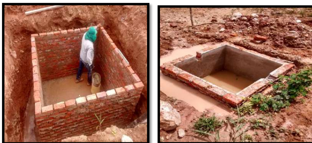
Fotografía 5553 Planta de tratamiento aguas residuales Cunday 1.
