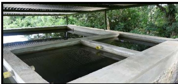
Fotografía 64: Tanque almacenamiento de agua.
