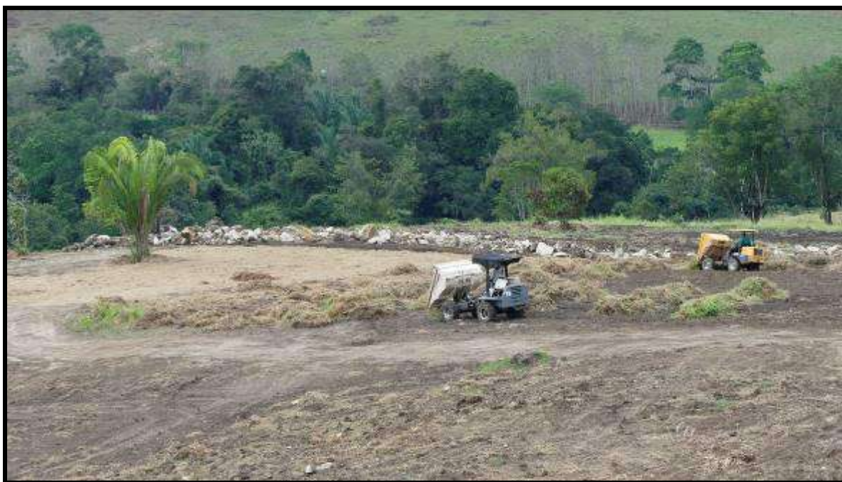
Fotografía 73 Disposición pasto seco para quema en sector afectado
