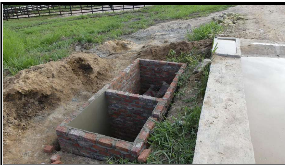
Fotografía 4240 Tanque y filtro para pileta de desinfección de vehículos.
