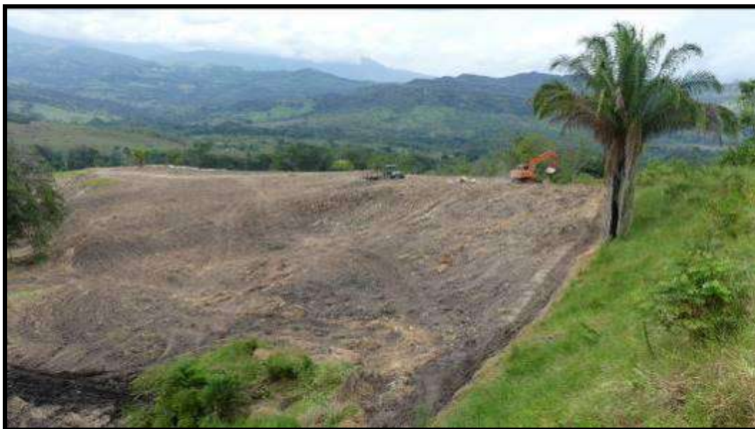
Fotografía 68 Sistema de drenaje del sector H
