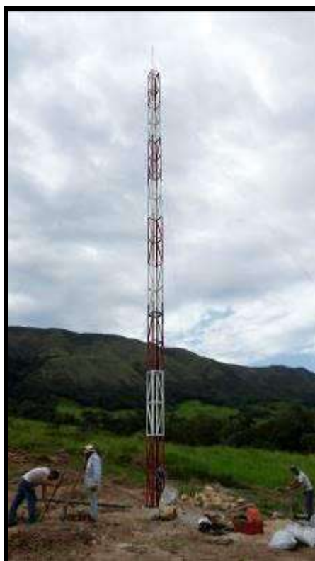
Fotografía 85 Instalación pararrayos sector E
