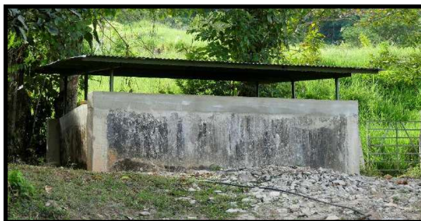
Fotografía 63: Tanque almacenamiento de agua.
