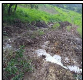
Afectación de las Vías por temporada Invernal
