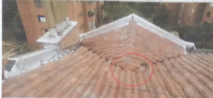
Possible infiltración donde nace la canal cambio de pendiente cubierta
