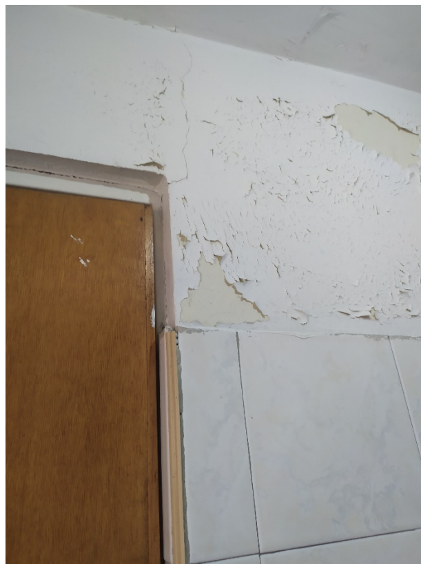
Fisuras que se han presentado en muros y dinteles en los dos niveles de la casa primero y segundo piso de la casa colindante.
