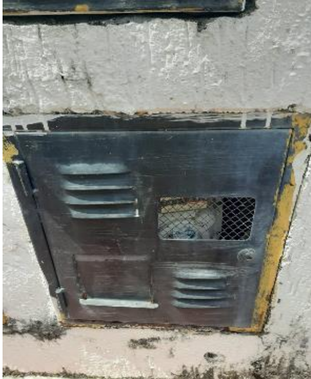
MEDIDOR DE GAS
