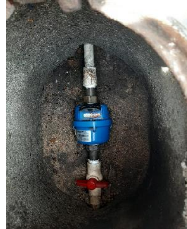
MEDIDOR DE AGUA
