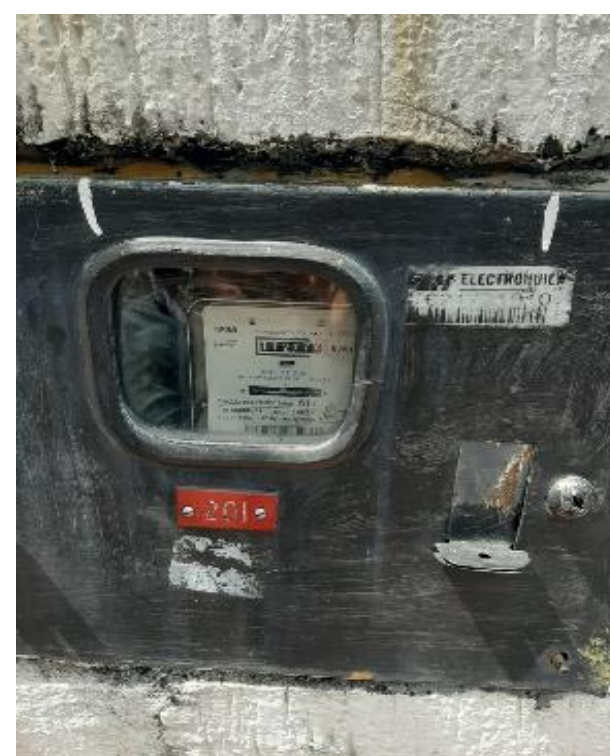
MEDIDOR DE ENERGIA
