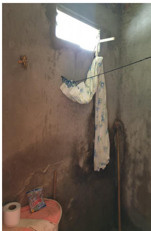
Imagen 7: Ducha funcional con acueducto.
