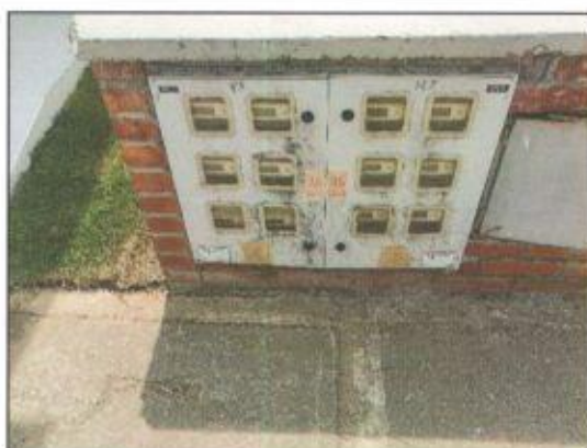
CONTADOR DE ENERGÍA ELÉCTRICA
