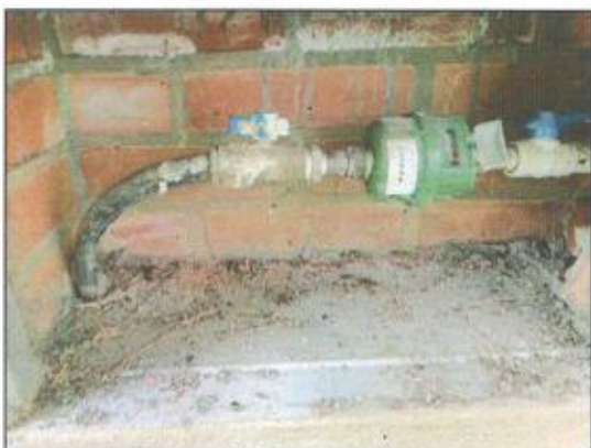
CONTADOR DE ACUEDUCTO
