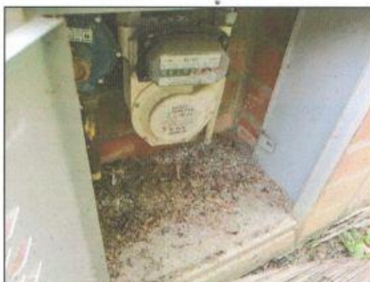
CONTADOR DE GAS
