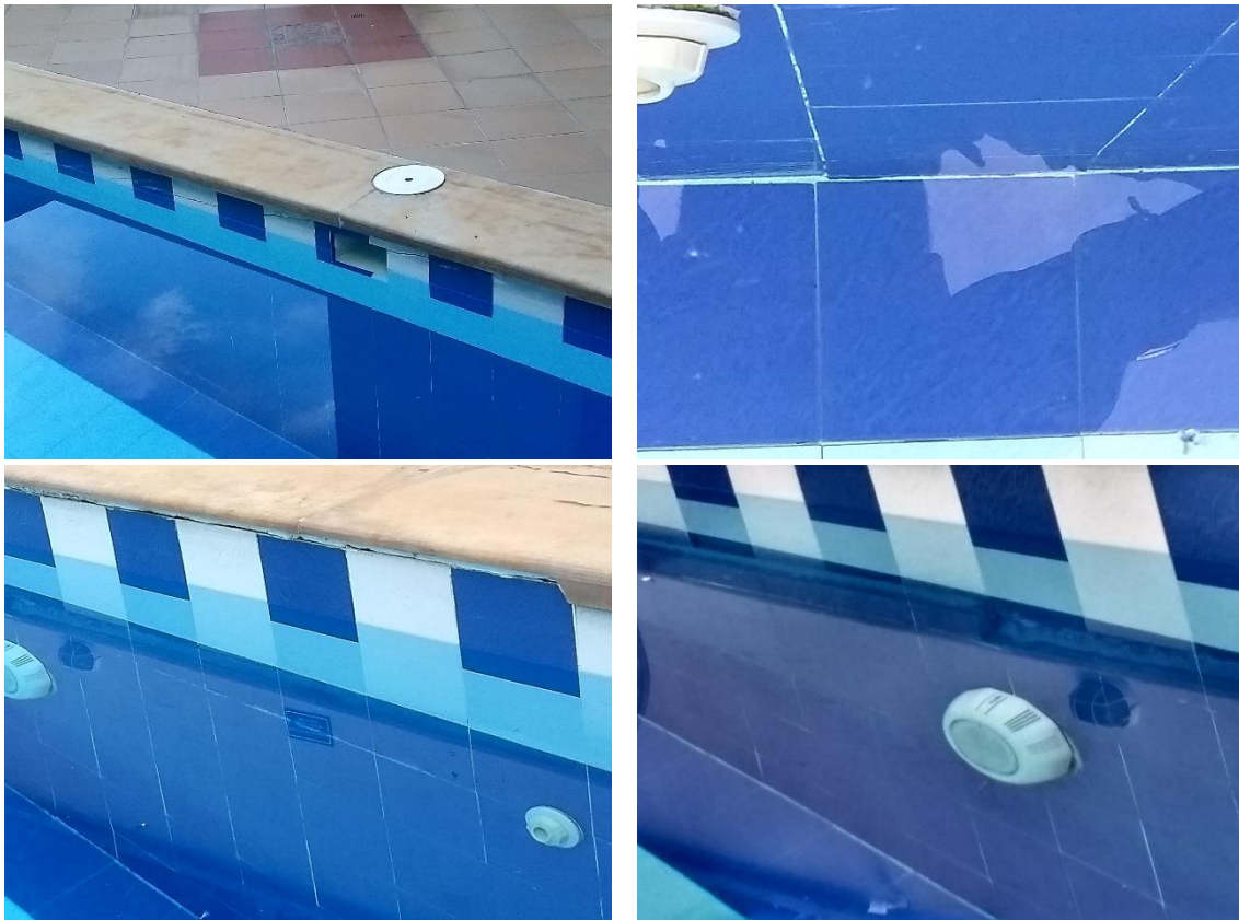
Imagen 10, 11, 12 y 13. Estado actual piscina
