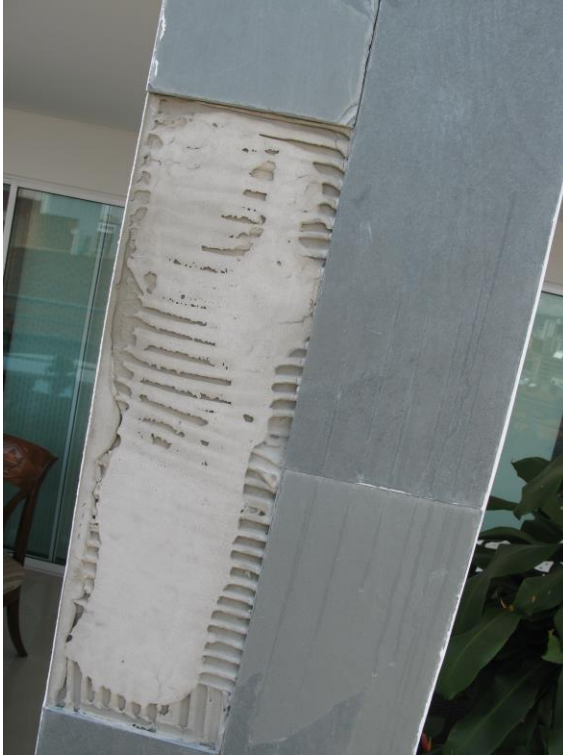
Desprendimiento de piedras pizarras. Por deterioro de material de pega
