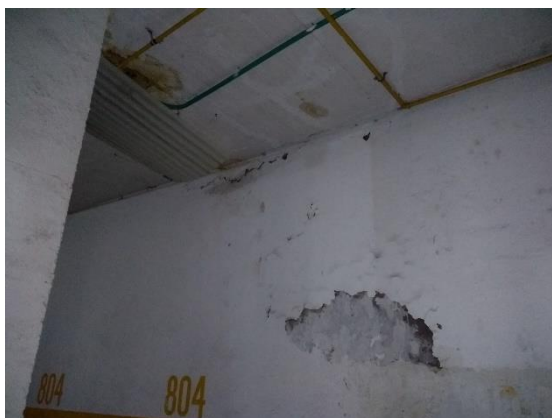
Imagen 29. Estado actual de humedad presente en sótano
