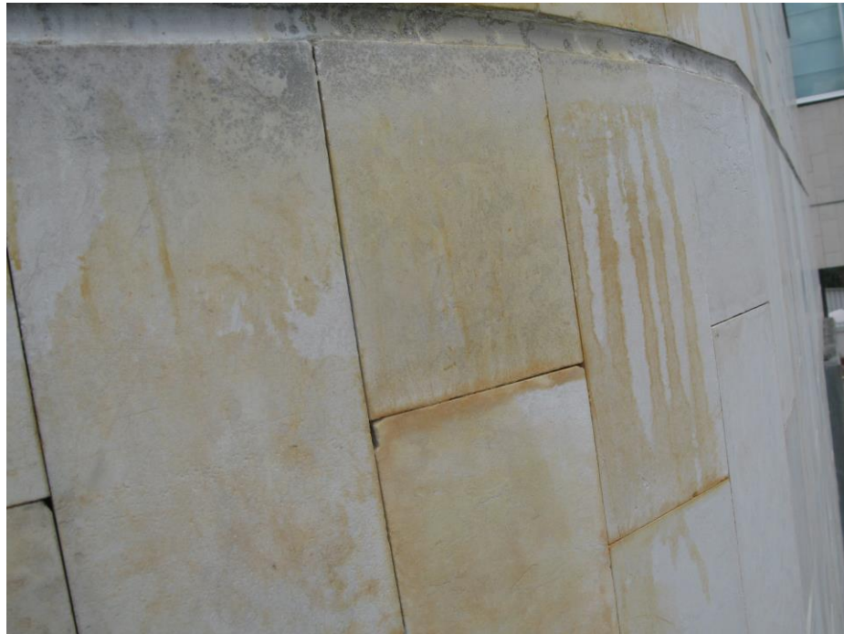
Manchas de oxidación, efloraciones de hongos presentes en la piedra de los balcones de los apartamentos de la entrada principal 4-02, 4-03
