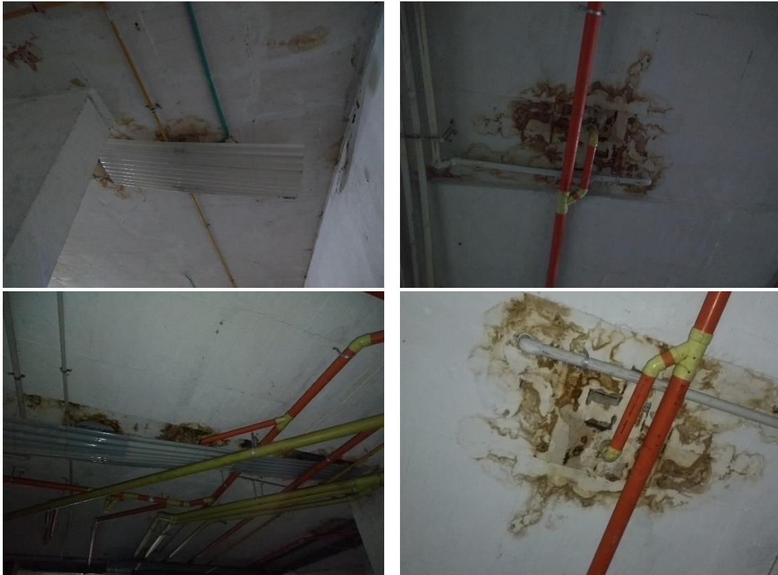
Imagen 25, 26, 27 y 28. Humedades bajo área adyacente a la piscina
