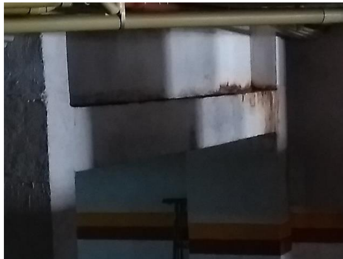
Imagen 22, 23 y 24. Humedades presentes bajo la piscina
