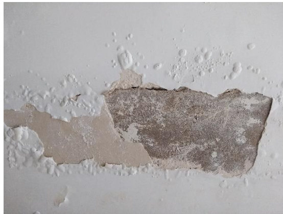
Imagen 34. Humedad en placa zona social
