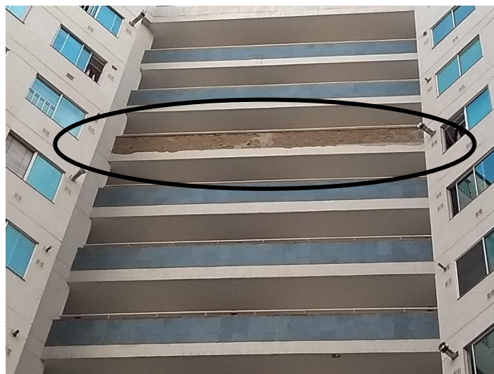
Imagen 8. Zona de porcelanato desprendida
