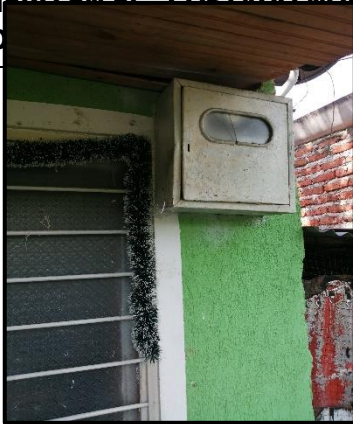
CONTADOR DE ENERGIA
