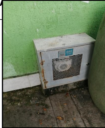
CONTADOR DE GAS DOMICILIARIO
