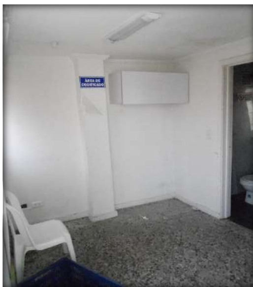
Adecuación / Área de Codificado
