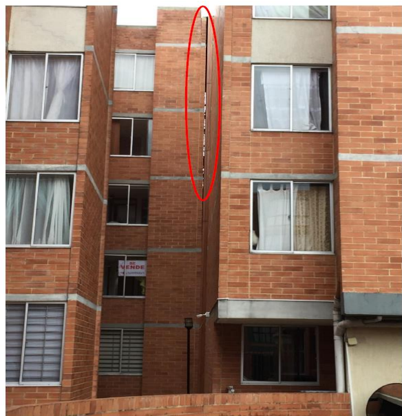
INCLINACION ENTRE LAS TORRES 2 Y 3
