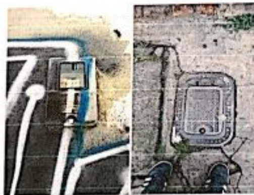
CONTADOR ELECTRICIDADY CONTADOR ACUEDUCTO.
