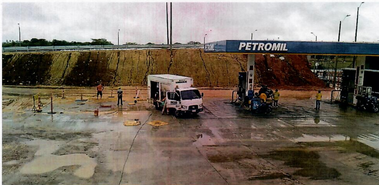
ZONA EROSIONADA DEL TERRAPLEN EN TIERRA ARMADA A CAUSA DE LLEVIAS
