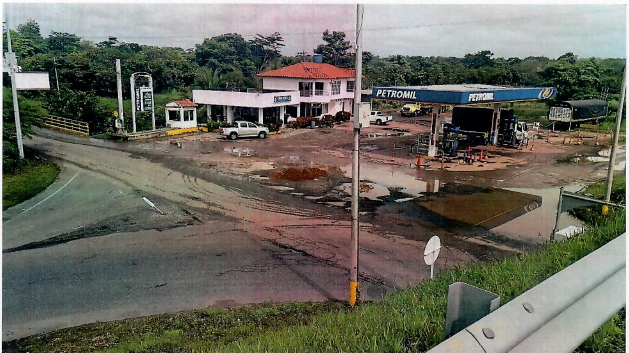
IMAGEN ZONA DURA DE LA EDS AFECTADA POR EL TRANSITO DE VEHICULOS
