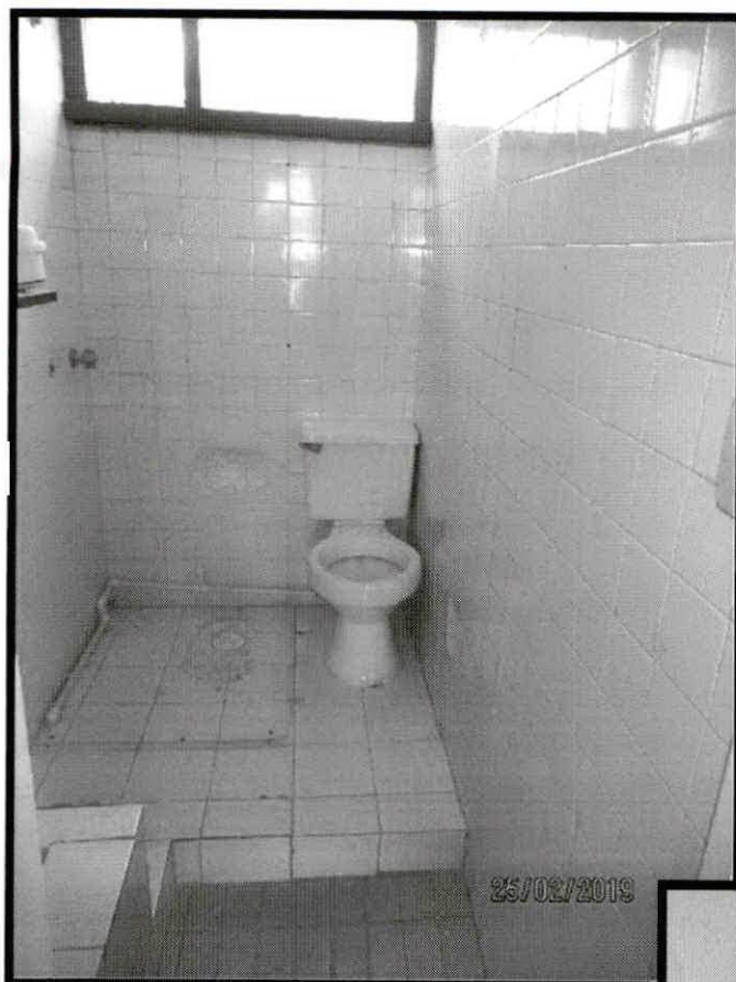
Foto 25/02/2019 Baño 2do Piso Sanitario sin arreglar.
