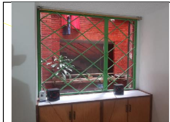
REJA INSTALADA HABITACION 1
