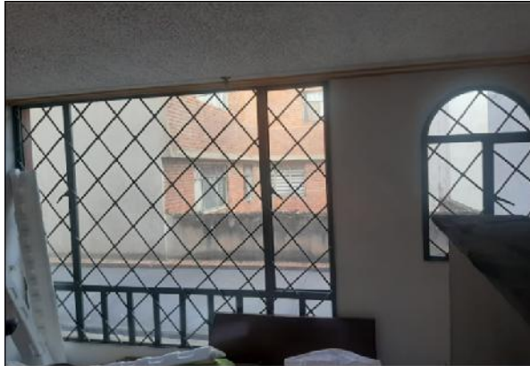
REJAS INSTALADAS SALA
