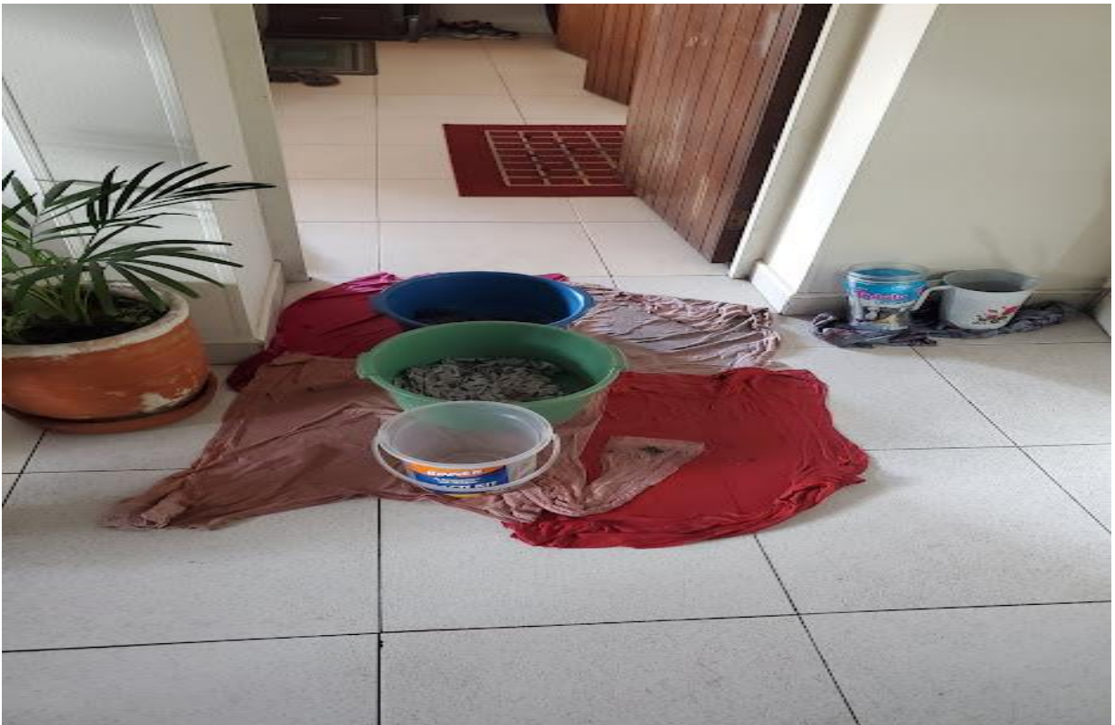
Evidencia del agua que cae del techo ubicado en la sala del apartamento jose rozo.
