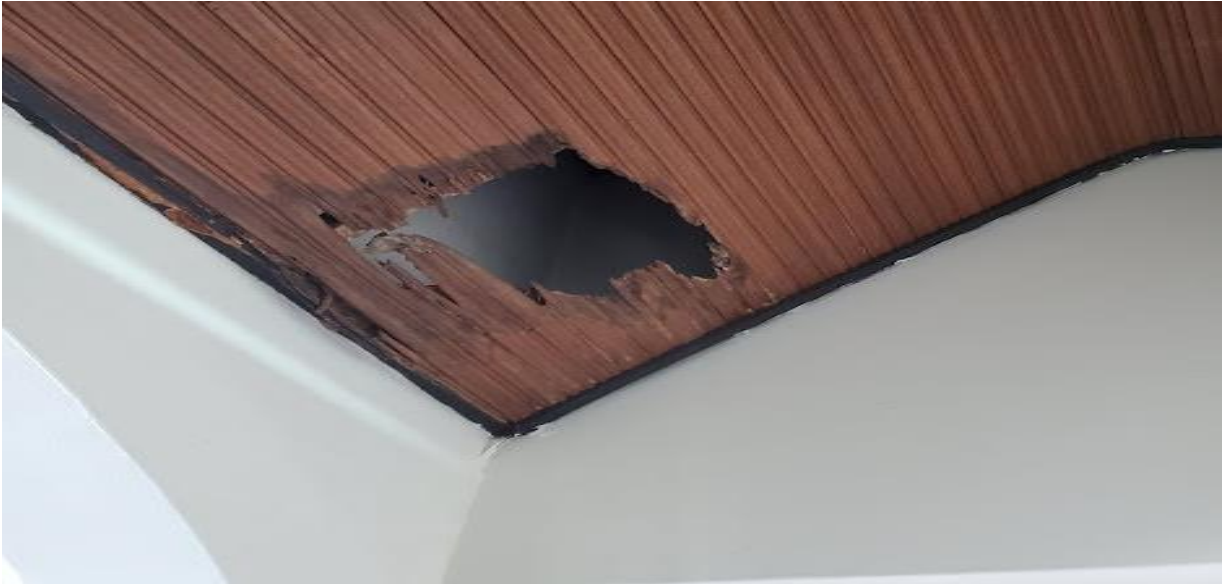
Daño del techo ubicado en la sala del apartamento del señor jose rozo.
