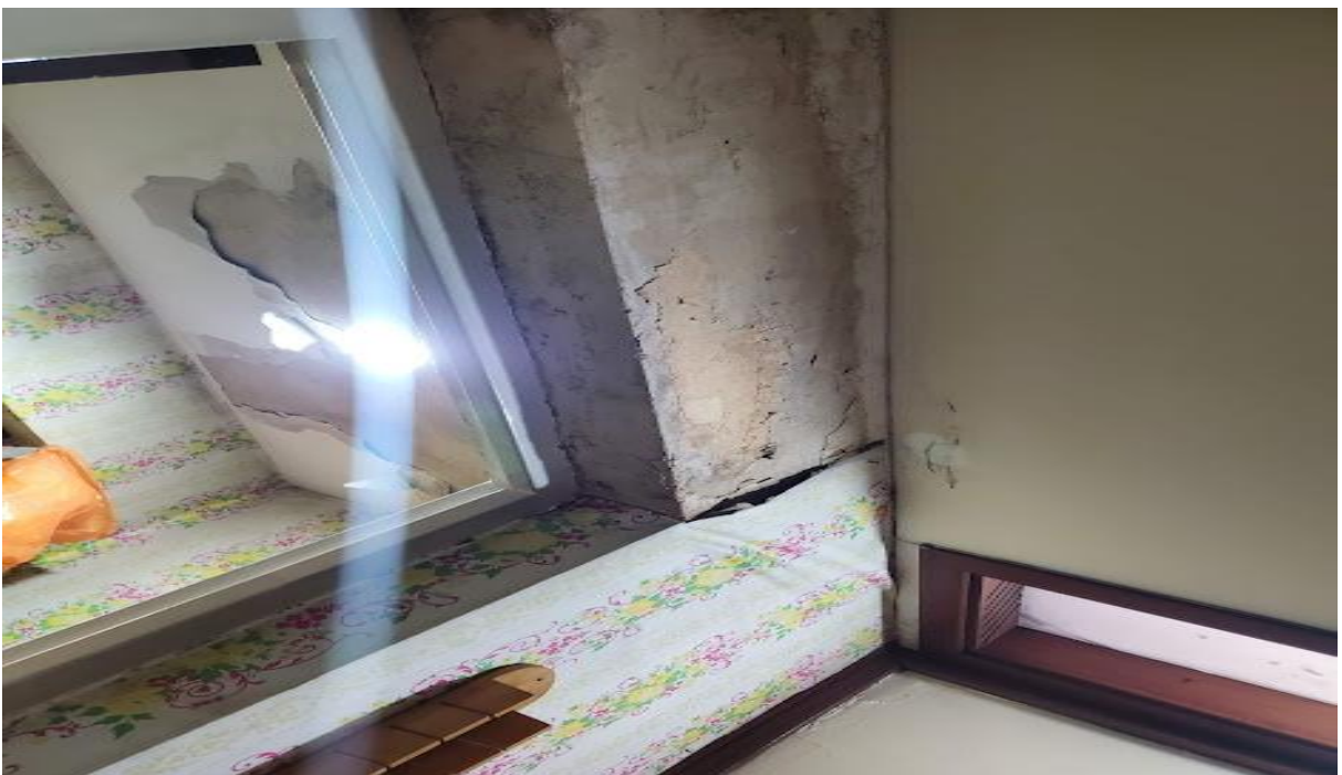
Humedad en uno de los baños en el apartamento del señor jose rozo.
