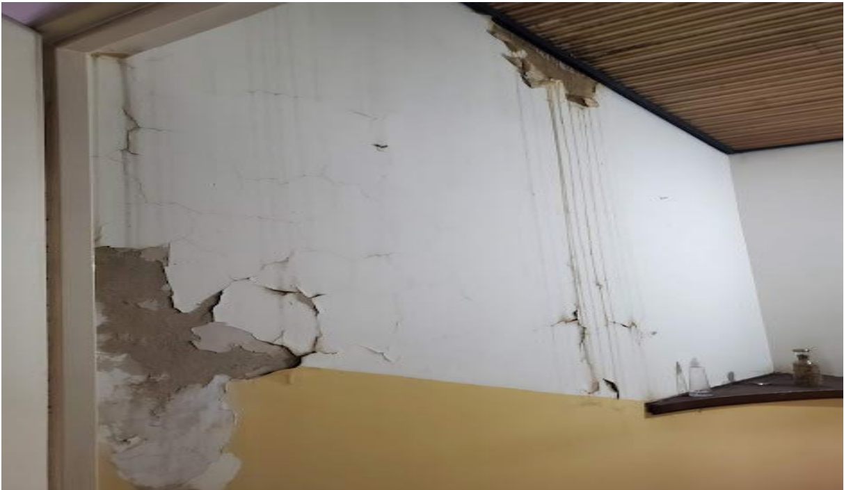
Humedad en la entrada al apartamento del señor jose rozo.
