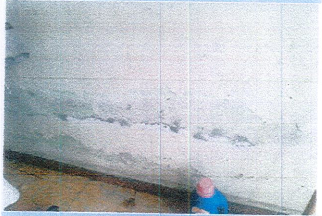
DETERIORO DEL INMUEBLE
