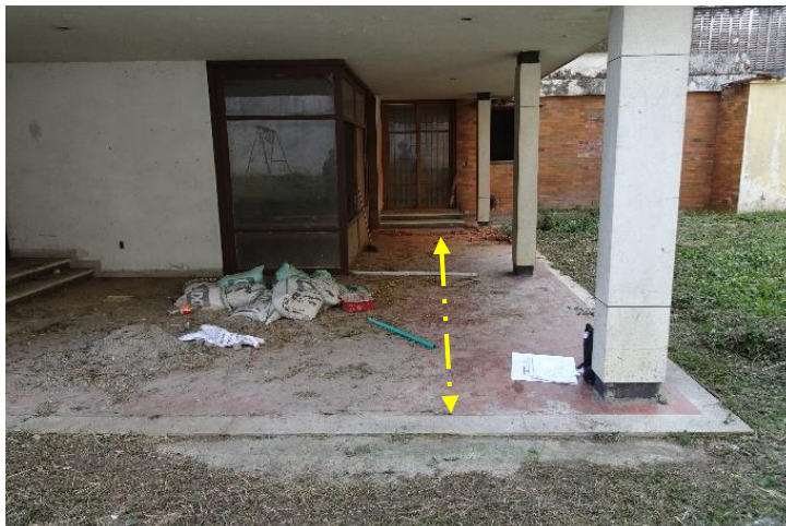
IMAGEN 23. AFLORAMIENTO DE CONCRETO EN EL JARDÍN. AFLORAMIENTO DE CONCRETO, EN DIRECCIÓN DE LOS ANCLAJES DE LA PRIMERA LÍNEA.
