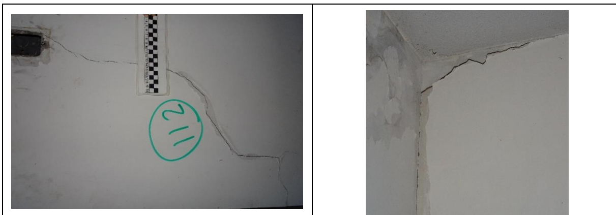
ESPACIO 211: Estadero, con presencia de grietas en la unión con los techos. Por asentamientos.
