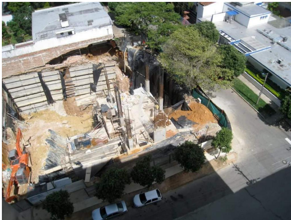
IMAGEN 12. GRADO DE AFECTACIÓN LA FOTOGRAFÍA DESCRIBE EL GRADO DE AFECTACIÓN CON EL COLAPSO DEL MURO EN LA COLINDANCIA CON LA CASA. Fuente: Familia Rey-Urbe.
