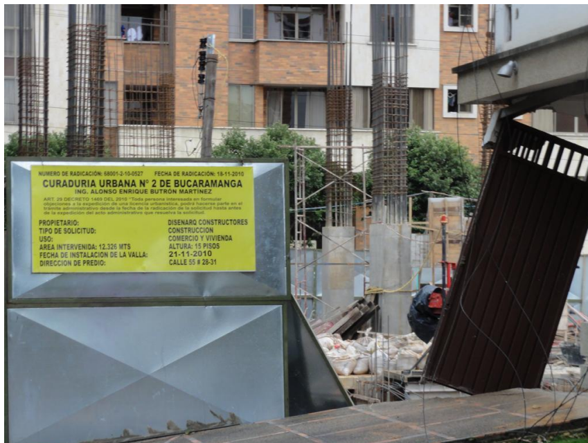
IMAGEN 16. ASPECTO FRONTAL DESDE LA CARRERA 29 A LA EDIF. OPUS. VISTA DESDE LA CARRERA 29, SE APRECIA EL GRADO DE AFECTACIÓN DE LA CASA AL PERDER SUS MUROS COLINDANTES CON LA NUEVA OBRA QUE SE DESARROLLA DEL EDIFICIO OPUS. Fuente: Familia Rey-Urbe.
