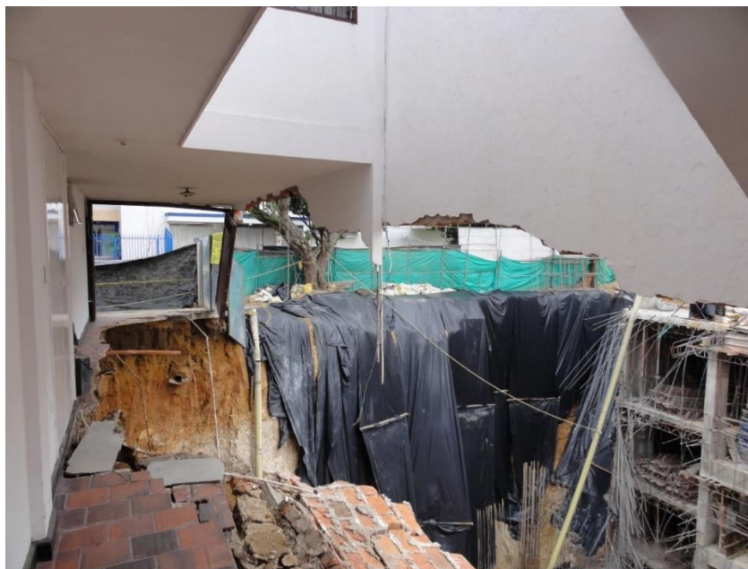
IMAGEN 17. ASPECTO INTERIOR CON VISTA A LA CARRERA 29. ASPECTO DEL CAOS, PRODUCTO DEL COLAPSO DEL MURO DE CONTENCIÓN Y AFECTACIÓN DE LA CASA. SE RESALTA LA PARTE DEL ANDEN Y DE LA VÍA PÚBLICA. LA SOCAVACIÓN PRODUCTO DEL DERRUMBE. Fuente: Familia Rey-Uribe.
