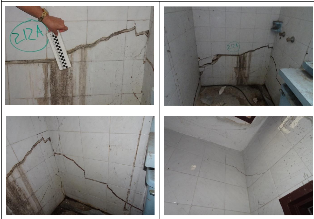
ESPACIO 212 A: Baño entre el estudio y cuarto de costura, este espacio colinda con el edificio OPUS. Esta muy afectado por acción de los asentamientos diferenciales y esfuerzo horizontales.
