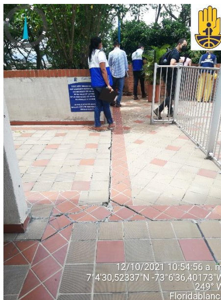
Imagen 27. Fisura o grieta en área de piscina. Fuente propia
