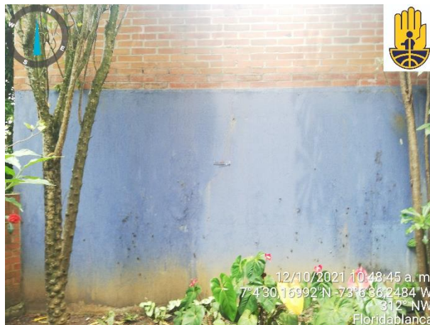
Imagen 25. fisurometro #3 en el sótano 2. Fuente propia
