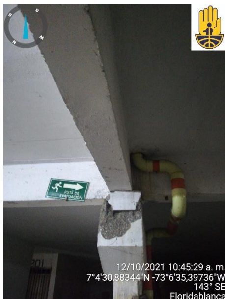
Imagen 16. Ménsula con pérdida de material, refuerzo al descubierto, sótano 2. Fuente propia
