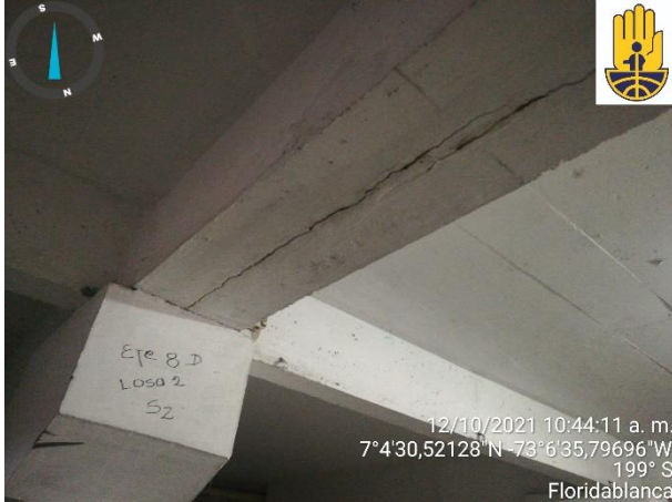
Imagen 6. viga con fisura o grieta en sótano 2. Fuente Propia
