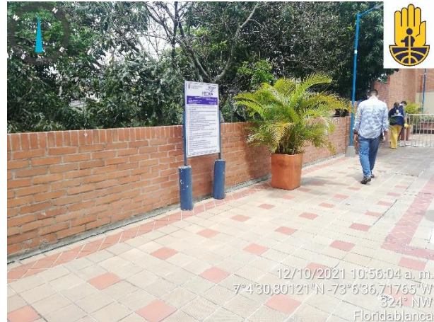
Imagen 29. piso del área de la piscina con hundimiento. Fuente propia
