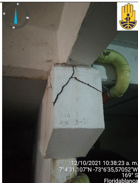
Imagen 11. Fisura o grieta en ménsula. Fuente Propia
