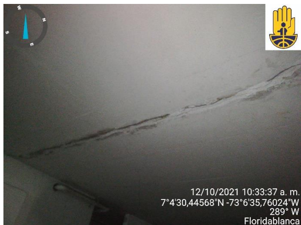
Imagen 13. fisura o grieta en placa, dentro de los parqueaderos. Fuente Propia
