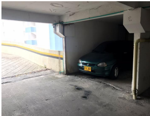
Imagen 2. Foto de grietas presentes en el piso de los parqueaderos. (Fuente: Propia)
