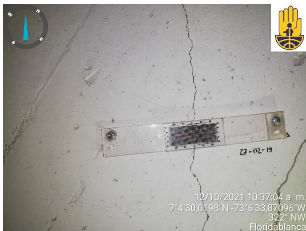
Imagen 22. fisuometro #1 en el sótano 3. Fuente propia
