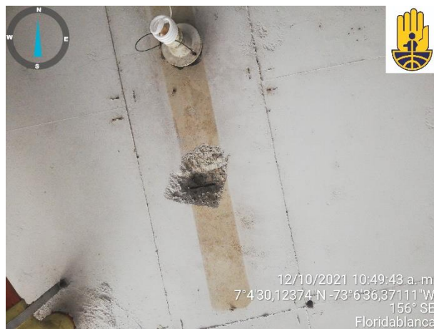
Imagen 20. placa en sótano 2 con pérdida de material y refuerzo al descubierto. Fuente propia
