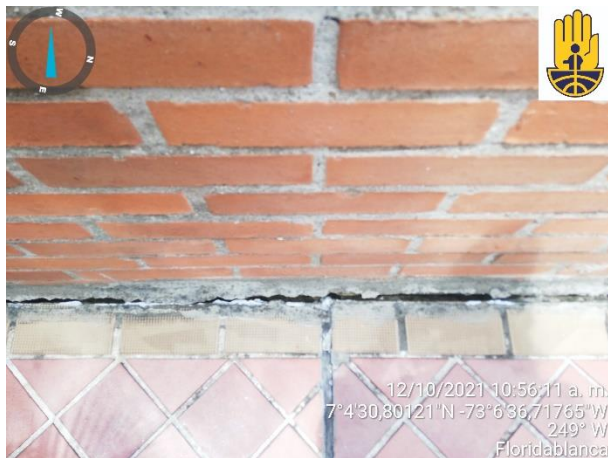
Imagen 30. separación entre muro y placa. Fuente propia
