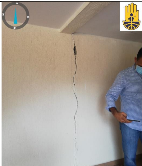
Imagen 14. fisura o grieta en pasillo hacia el área de la piscina. Fuente propia
