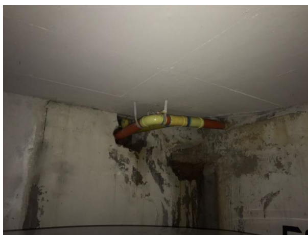
Imagen 5. Tubería dañada. (Fuente: Propia)
