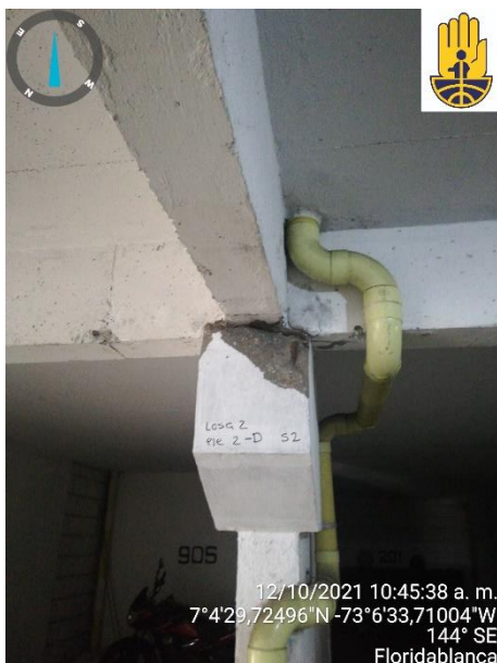
Imagen 15. Ménsula con pérdida de material, refuerzo al descubierto, sótano 2. Fuente propia
