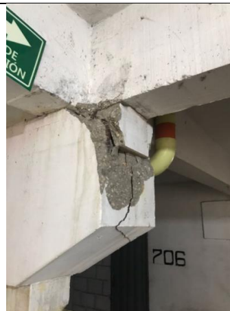
Imagen 4. Detalle de viga con fallas. (Fuente: Propia)
