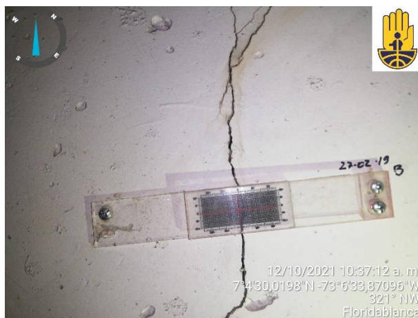
Imagen 23. fisuometro #2 en el sótano 3. Fuente propia
