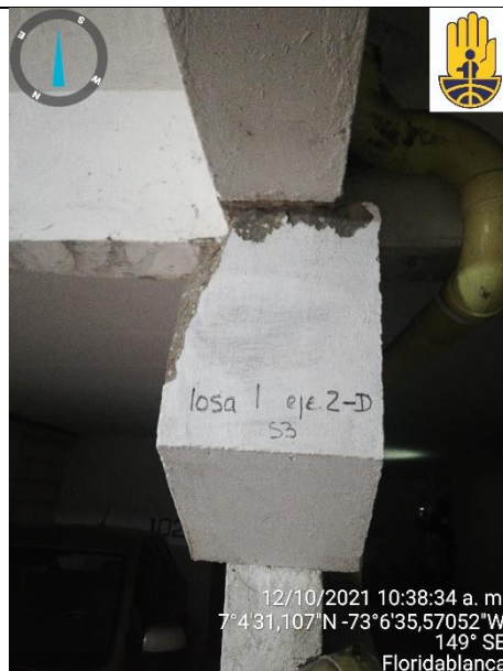
Imagen 18. Ménsula con pérdida de material, sótano 3. Fuente propia
