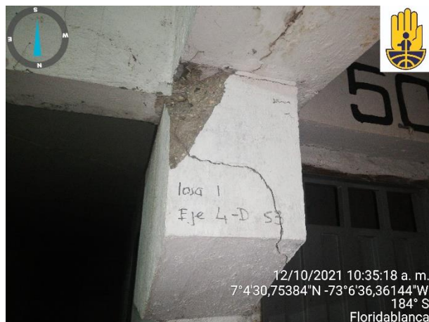
Imagen 19. Ménsula con pérdida de material, sótano 3. Fuente propia
