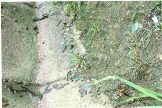
Foto 13. Foto Plano medio. Trozos de vidrios en la cuneta, sentido San Alberto - Bucaramanga
