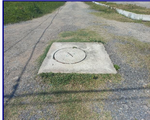
CAJA DE ALCANTARILLADO
