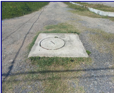
CAJA DE ALCANTARILLADO
