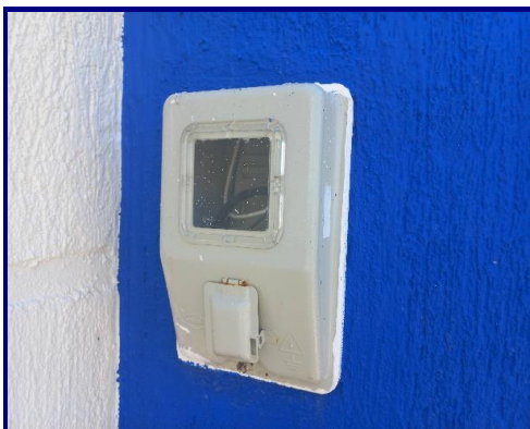
MEDIDOR DE ENERGIA ELECTRICA{
