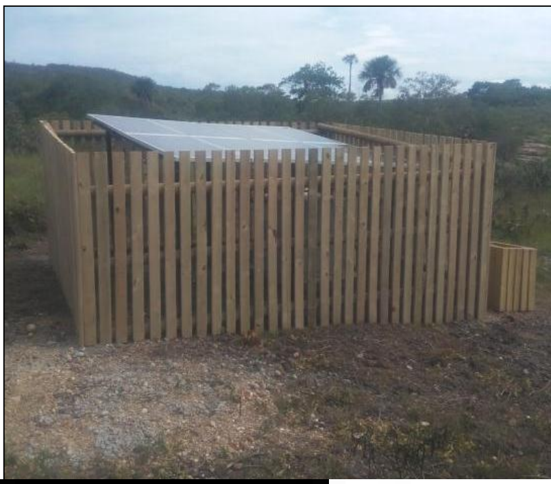
AREA DE PANELES
